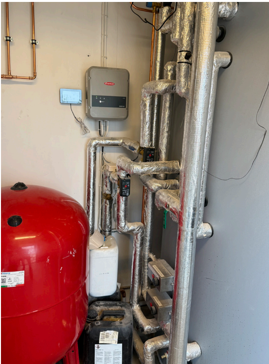
Det begränsade teknikrummet rymmer trots sin storlek den vattenvolym som krävs för anläggningen.
